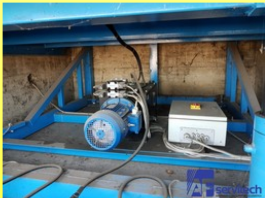
Manutenzione impianto elettroidraulico
