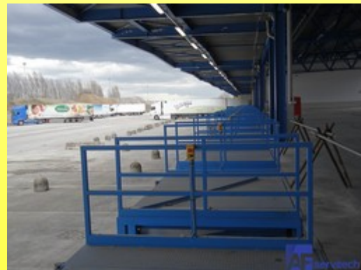
Manutenzione sistemi di sicurezza
